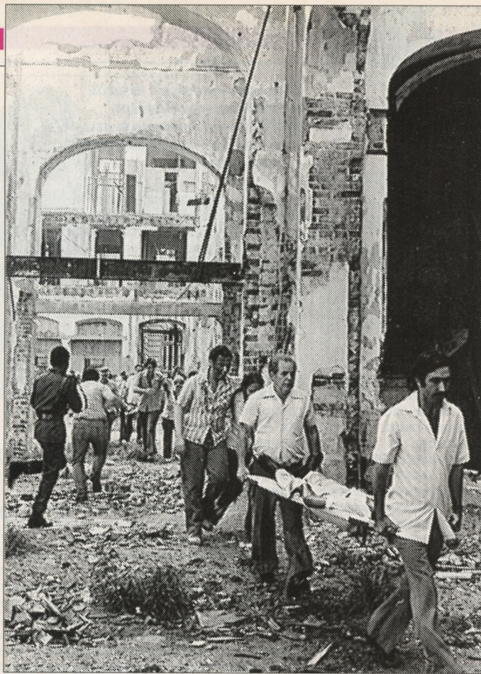
Старая Гавана больше всего напоминает город, подвергавшийся на протяжении многих лет систематическим воздушным бомбардировкам
